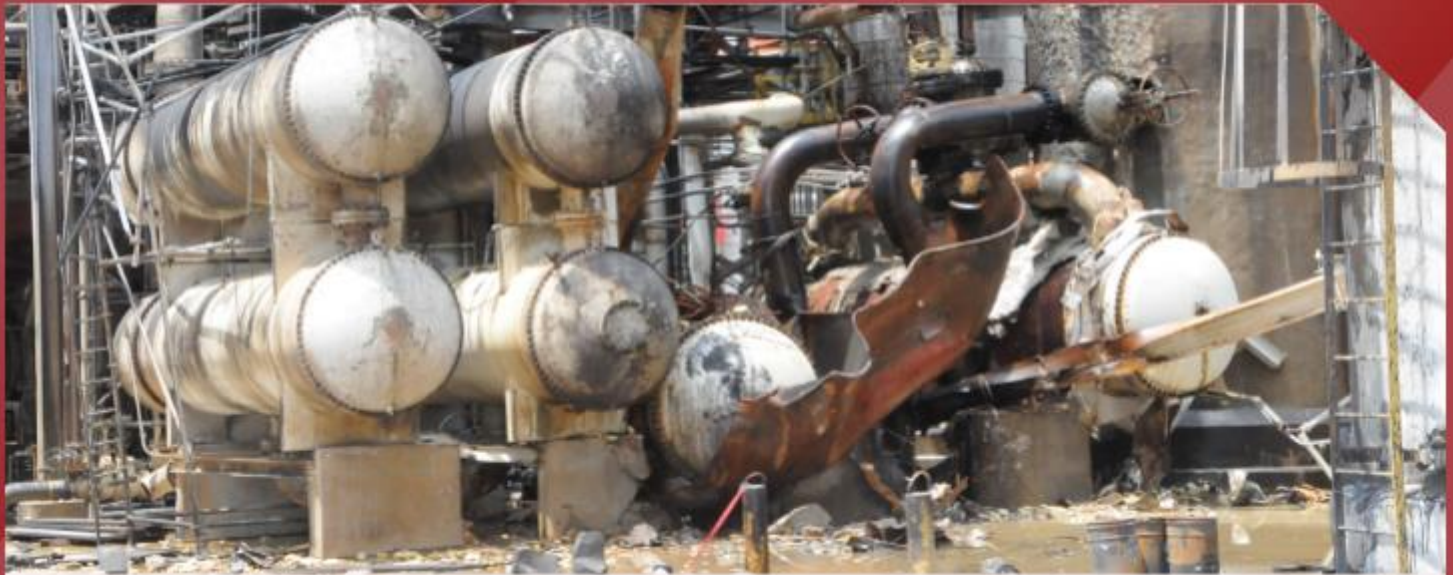
Vista del intercambiador de calor dañado en la planta Williams Olefins.
